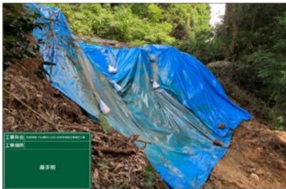
【穴水～能登鹿島間のり面崩壊着工前】
